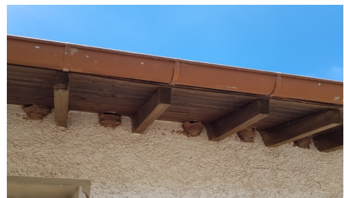
Abb. 20: Schwalbennester am Gebäude des Bauhofs
